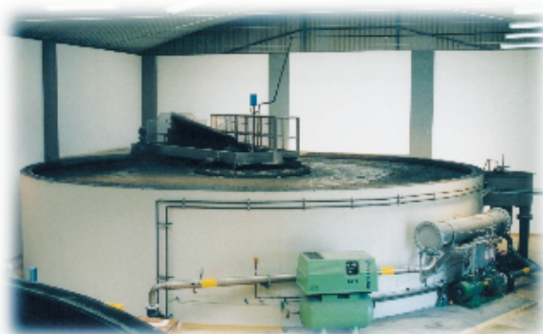
SDC 36 - Clarification et concentration de boues (lavage de biofiltre)
