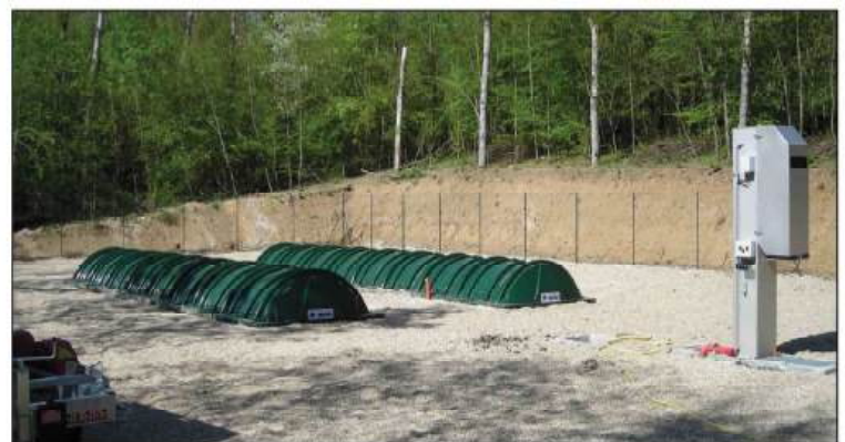
2 stations BLIVET en parallèle, précédées d'un dégrilleur automatique
