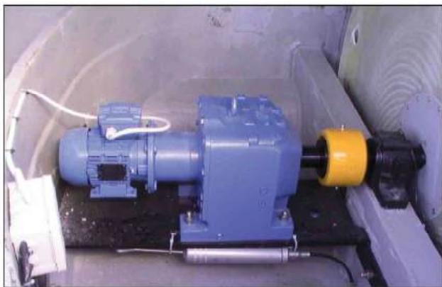
Ensemble moteur et moto réducteur station BLIVET
