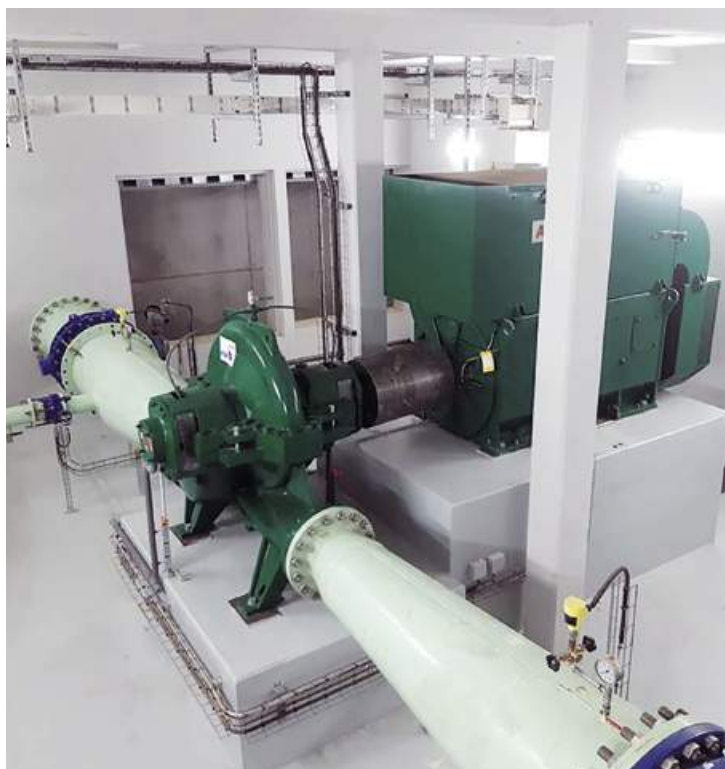
La pompe RDLO 350-850 A SC, pompe la plus puissante installée par la Société du Canal de Provence avec un moteur de 2,4 mégawatts alimenté en 690 volts, une puissance nécessaire pour satisfaire les besoins des usagers et des nombreux estivants.
