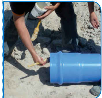
Appliquer le gel lubrifiant sur le chanfrein de l'extrémité mâle et sur le joint de l'emboîture.
