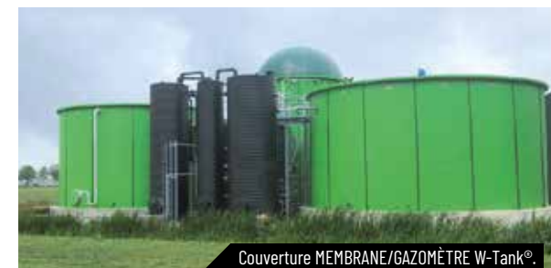
Couverture MEMBRANE/GAZOMÈTRE W-Tank®.
