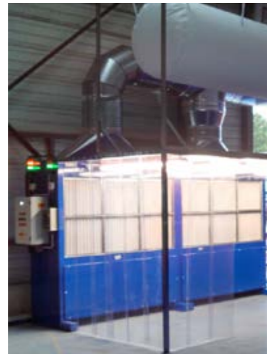
CA400 So - Ponçage de pièces avant peinture Recyclage de l'air dans l'atelier par gaine textile
