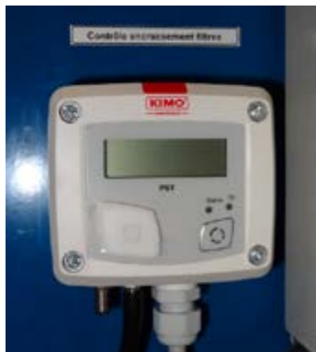
Contrôle encrassement filtre
