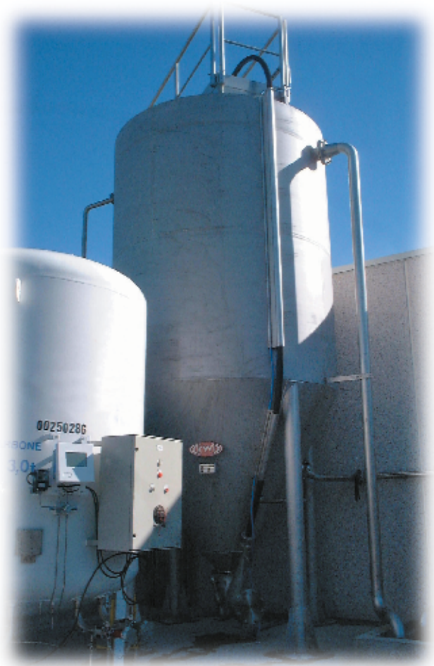
KSF 5-2 - Traitement tertiaire (déphosphatation)
