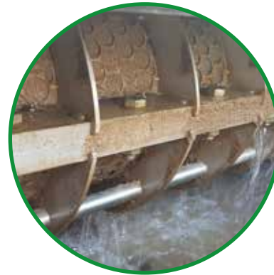
Traitement des boues
