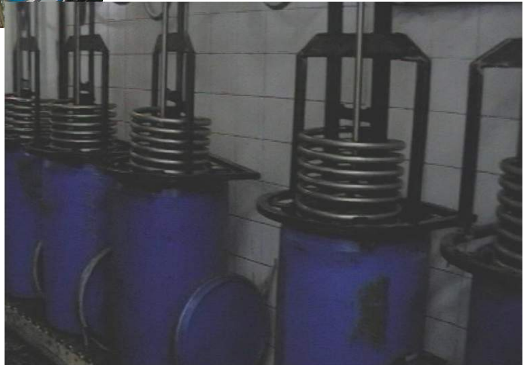
Détail du chauffage des fûts
