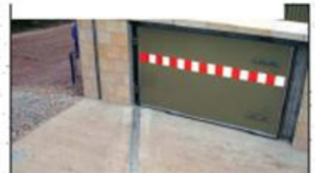
Rail encastré au sol
