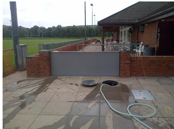
Fig 12. 2013: Ledbury Rugby Club, Mur de 98 m avec de nombreux FloLift V protégeant les ouvertures.
