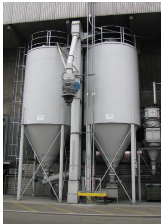
Ver- und Entsorgungsstation in Silo-Ausführung mit Füllstandsmessung
