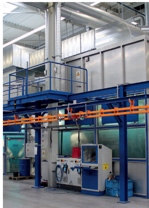
Umluft-Lackieranlage mit Hängeförderer bei der Allgaier Automotive GmbH
