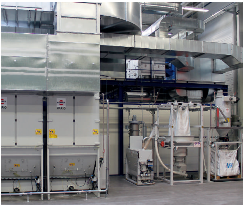
RECLAIM Trockenabscheidung bei der Allgaier Automotive GmbH Volumenstrom: 86 000 m 3 /h Rohgasbelastung: bis 130 mg/m 3 Overspray-Mengenanfall pro Woche: ca. 800 kg
