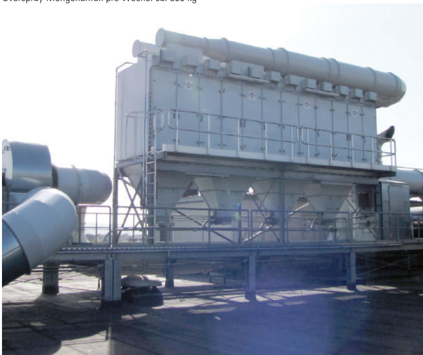
RECLAIM Trockenabscheidung von Dieselrußpartikeln eines Dieselmotorenprüfstandes Volumenstrom: 60.000 m 3 /h
