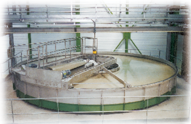
SPC 27 - Effluent de verrerie
