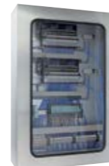
Coffret de pilotage.
