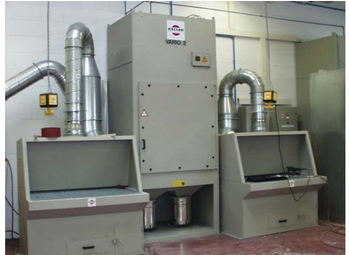
Postes de meulage manuel
