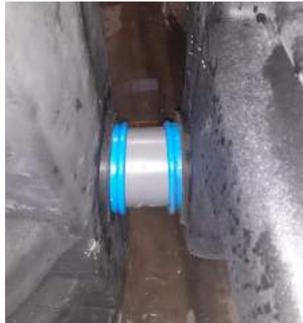
Fig-8 : raccordement du relevage au filtre compact x-perco® R-90 monobloc
