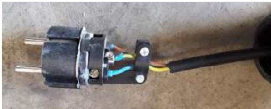
Fig-28 : câbles électriques relevage
