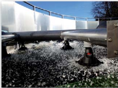
Distribution des effluents
