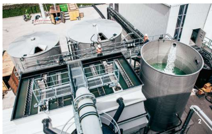
1 Bassin de sédimentation, filtres à sable et à charbon actif, IN-Campus Ingolstadt / 2 Installation de traitement des eaux, épuration du sol, IN-Campus Ingolstadt / 3 Bassin de sédimentation, centrale thermique Mühlhausen
